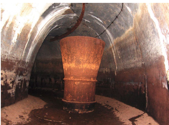
Überlauftrichter im Wasserschloss
