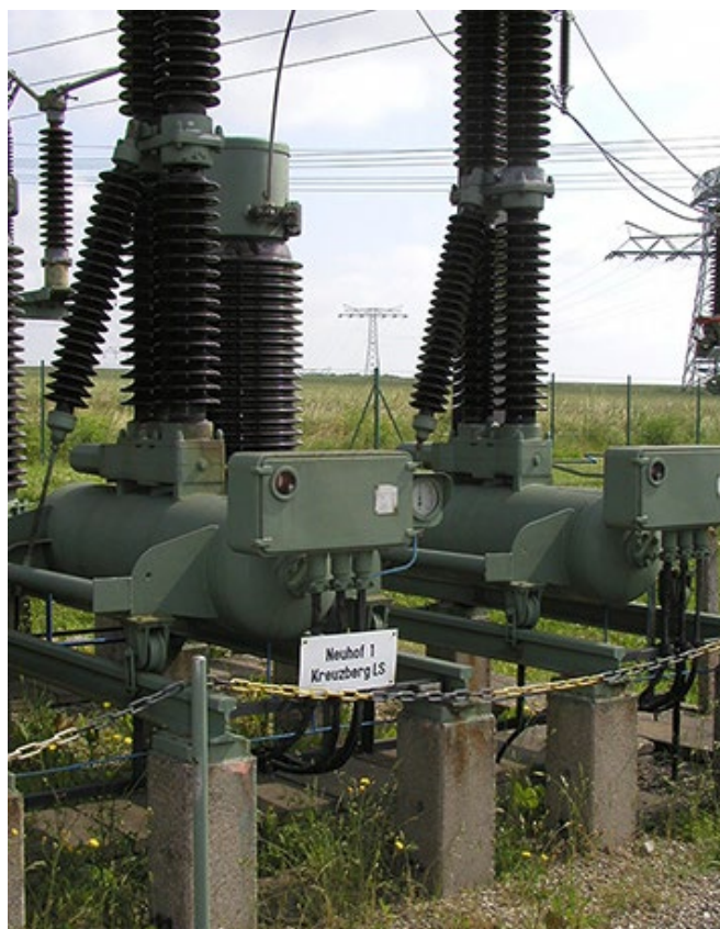
UW Wolframshausen, 110-kV-Schaltfeld Neuhof 1
