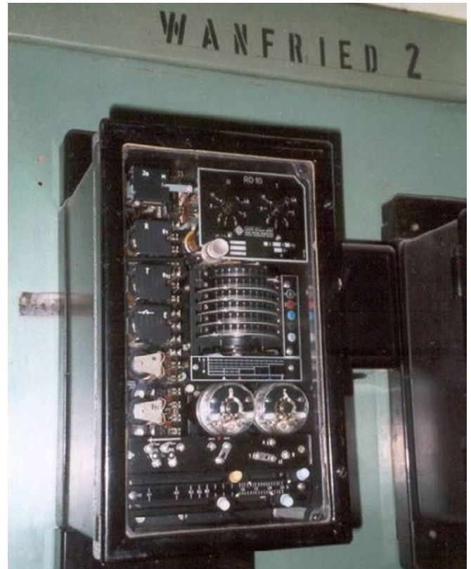
Distanzschutz RD10, EAW, UW Katharinenberg, 30-kV-Leitung Wanfried
