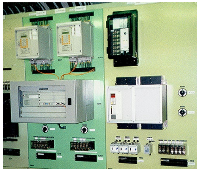
Schutztafeln im UW Remptendorf, 220(380)-kV-Abgang Redwitz 253/254, Hauptschutz Distanzrelais PD551 mit AWE-Zusatz RM1-80, AEG und Reserveschutz Leitungsdiff. 7SD512 mit Signalübertragungsgerät SWT2000D, Siemens
